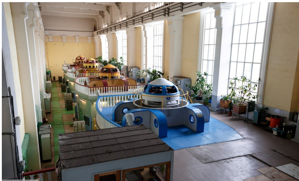
Рис. 15. Машинный зал Нижне-Тулумской ГЭС [7]
