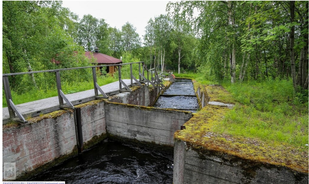
Рис. 16. Рыбоход на Нижне-Тулумской ГЭС [7]
