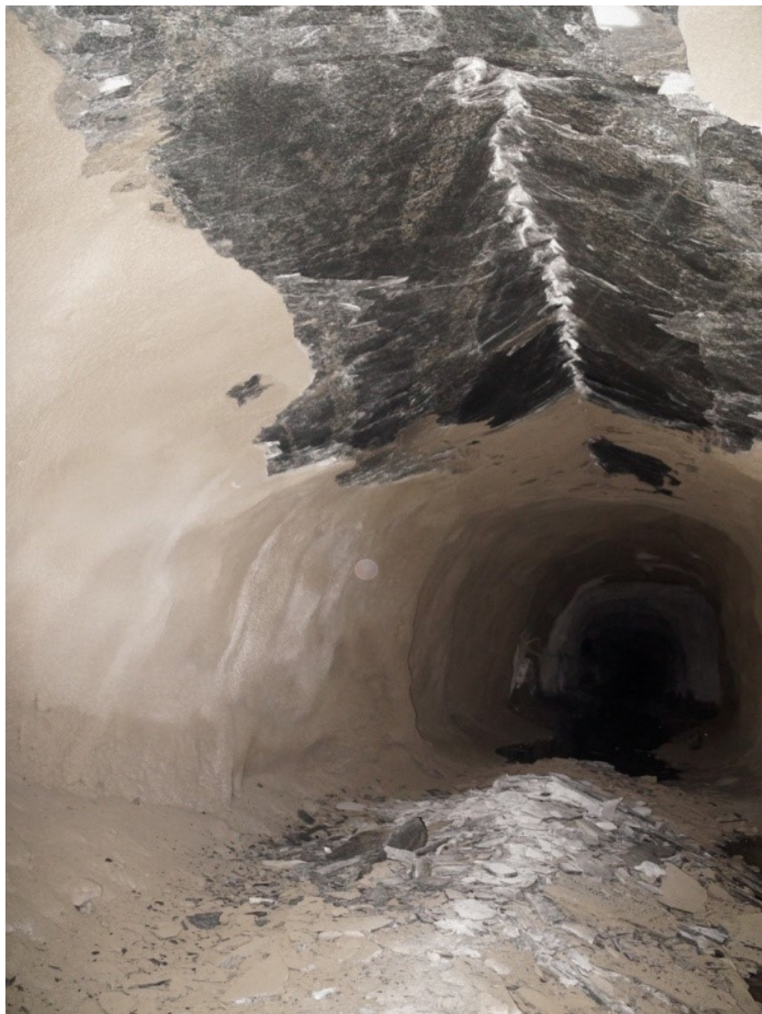
Рис. 6. Категория состояния Г. Динамическое заколообразование по кровле. Расвумчоррский рудник
