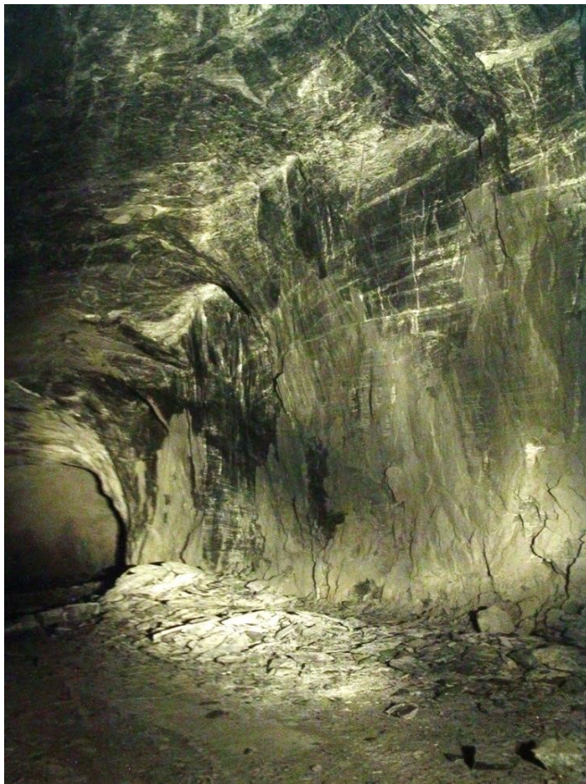
Рис. 5. Категория состояния Г. Интенсивное шелушение по сопряжению кровли со стенкой. Расвумчоррский рудник
