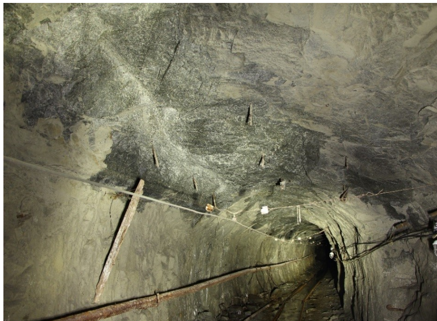
Рис. 5. Шелушение по сопряжению кровли со стенкой. Рудник «Карнасурт», западный рудный штрек
