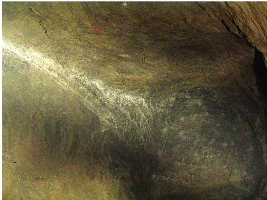
Рис. 4. Категория состояния В. Шелушение по сопряжению кровли со стенкой. Расвумчорский рудник
