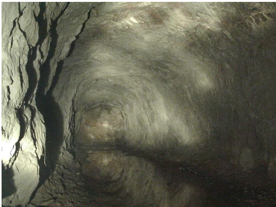
Рис. 1. Категория состояния А. Выработка сохраняет устойчивость. Расвумчоррский рудник
