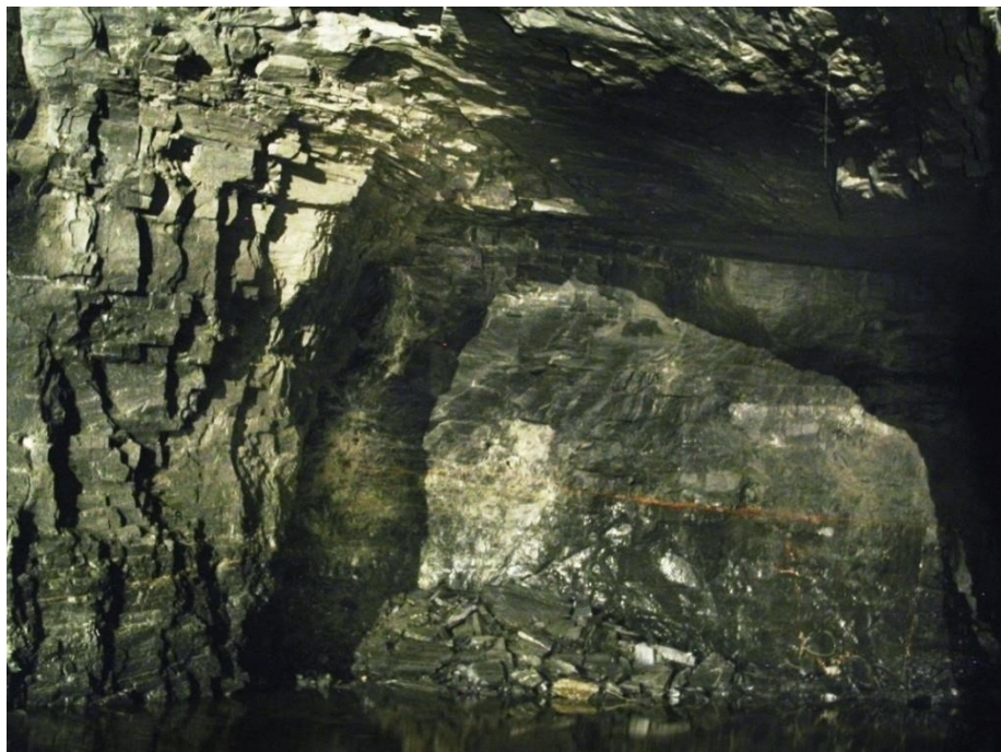
Рис. 2. Категория состояния Б-1. Наблюдаются вывалы по трещинам. Расвумчорский рудник
