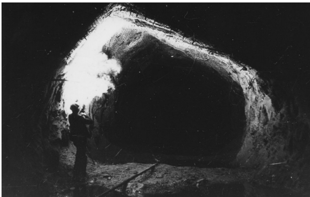
Рис. 3.4. Искажение проектного сечения кровли выработки вследствие влияния горизонтальных тектонических сил (рудник «Умбозеро», штрек гор. + 170 м, глубина 400 м). Фигура на снимке — автор монографии
