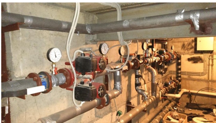
Рис. 52. Индивидуальный тепловой пункт
