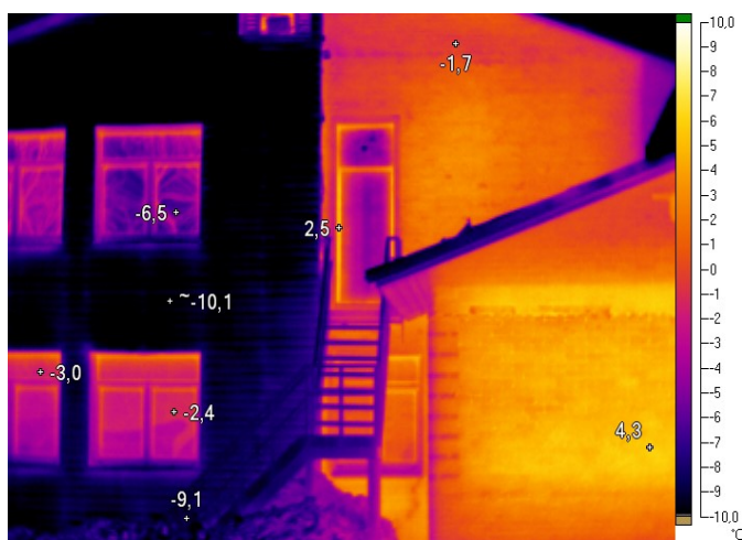
Рис. 49. Термограмма наружной торцевой стены детского сада
