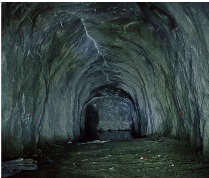
Рис. 5.17. Характер разрушения контура выработки (автоуклон — +234/–220 м)
