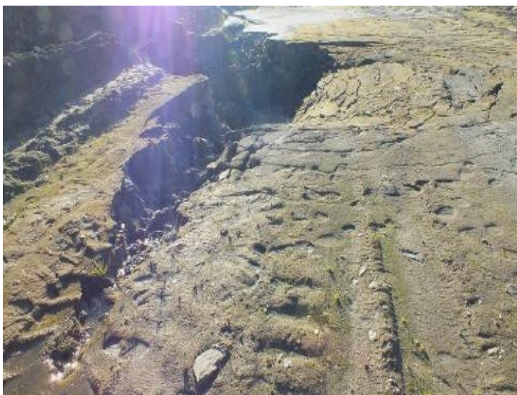
Рис. 4.12. Инфильтрация воды в область деформации ограждающей дамбы
