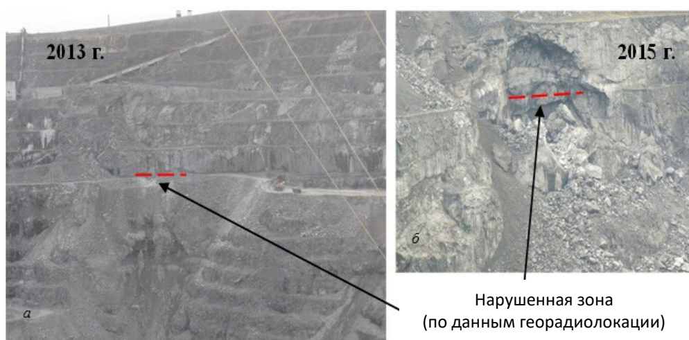
Рис. 3.19. Обрушение по выявленной нарушенной зоне: a — фрагмент борта до обрушения, б — фрагмент уступа после обрушения
